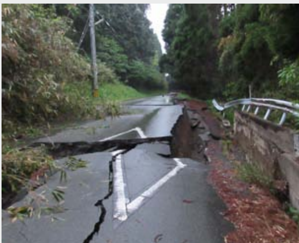
筆者の自宅近くの道路。激しい揺れで地盤が引き裂かれ、通行は不可能だった
